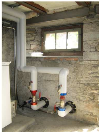
Eintritt Stichleitungen FW
